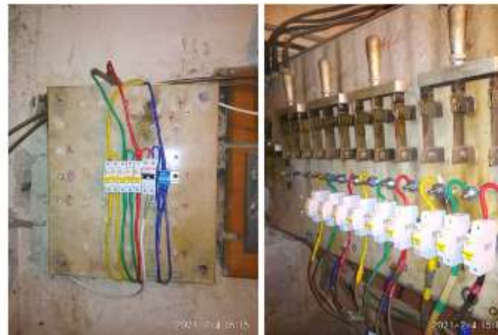
04.02.2021 Ремонт ГРЩ в МКД по адресу: г. Пушкин, Конюшенная ул. д. 38/37 ⚡ #жкс2пушкин
