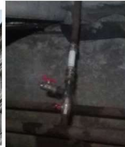
20.10.2020 Замена участка стояка ЦО с краном и спец.сгоном, восстановление ЦО, г. Пушкин, Ленинградская ул. д. 45 кв 3
