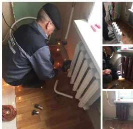
27.10.2020 Замена стояка ЦО, замена радиатора, стояк залуцен г. Павловск, Гуммолосаровская ул. д. 11 -3.
