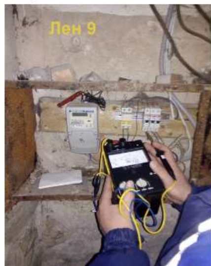
05.04.2021 Замер сопротивления изоляции г. Пушкин, Ленинградская ул. д. 9 #жкс2пушкин
