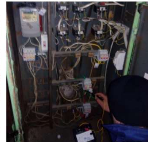
19.04.2021 Замер сопротивления изоляции. г. Пушкин, Ленинградская ул. д. 18 #жкс2пушкин
