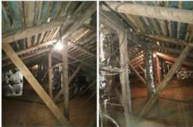
07.09.2020 Освещение чердачного помещения г. Пушкин, Магазиная ул. д. 17/40
