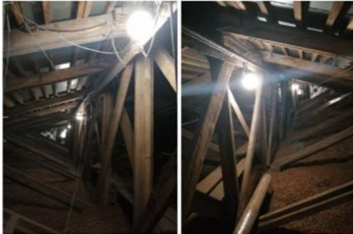
07.09.2020 Освещение чердачного помещения г. Пушкин, Московская ул. д. 10
